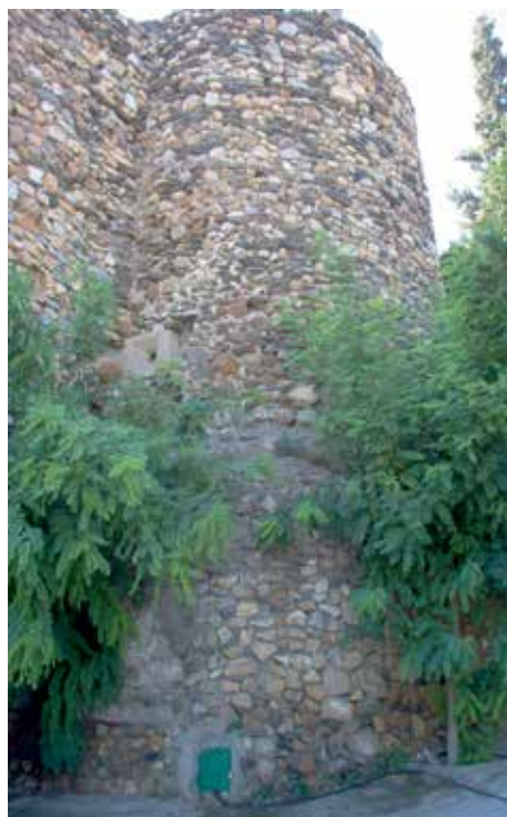
Torre antes y después del derrumbe, se aprecia la mampostería organizada y separada por líneas de esquistos entre el zócalo y la base de la torre.
